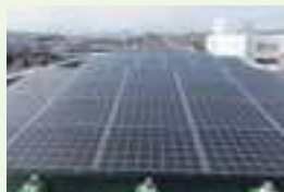
太陽光発電パネルの屋上設置
